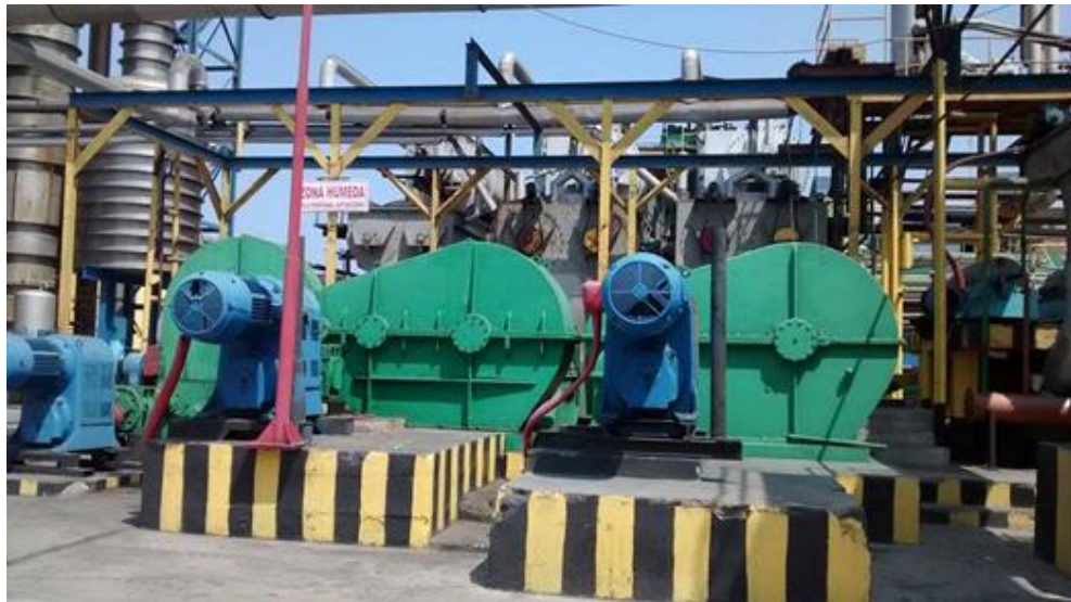
Figura N°11 Instalaciones Área de secado de la Planta 1313 Chimbote
