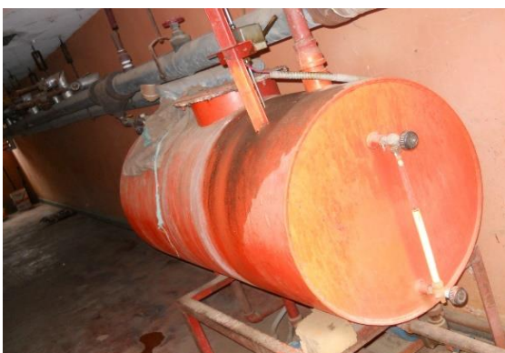
Tanque de condensado sótano de cocina sin aislamiento.
