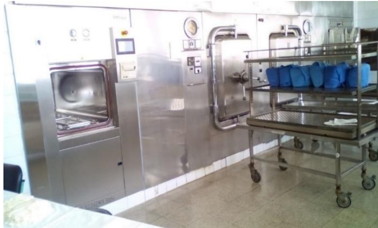
Figura N° 29: Central de Esterilización.
