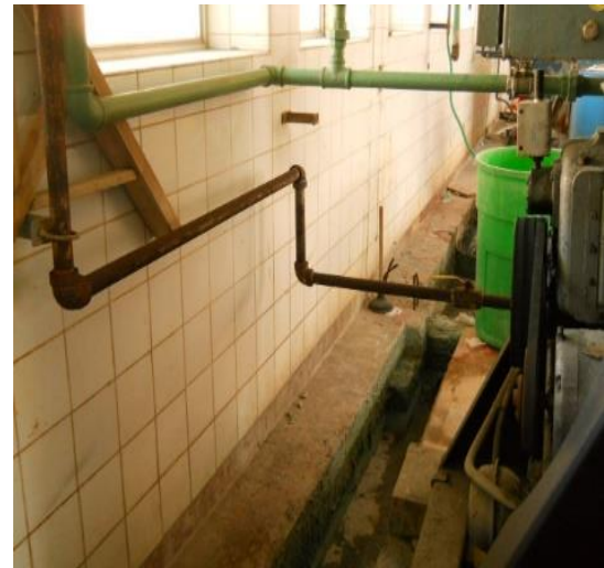
Ramal de vapor sin aislamiento
