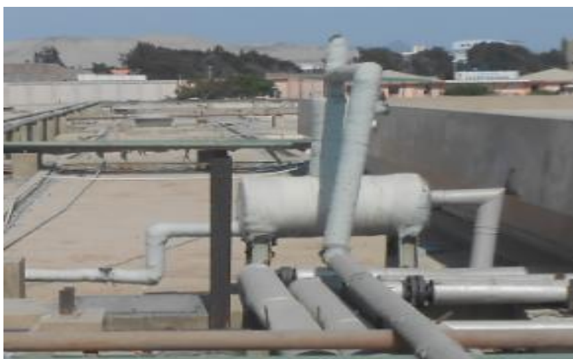
Figura N° 62: Tanque revaporizador del servicio de Lavandería.
