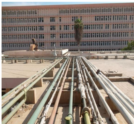
Redes de distribución de vapor.
