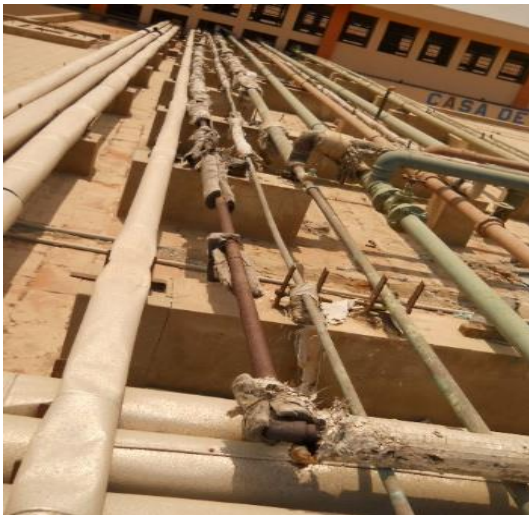
Aislamiento deteriorado Red de vapor flash.
