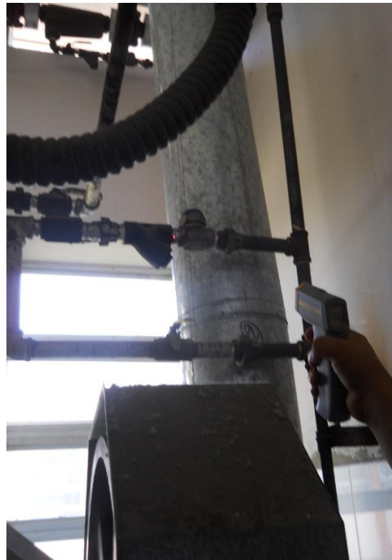
Inspección de trampas de vapor por método de temperatura.
