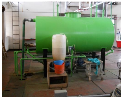
Tanque recolector de condensado sin asilamiento
