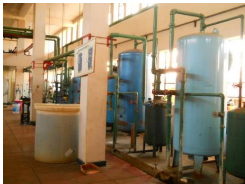
Equipos para Tratamiento externo del agua
