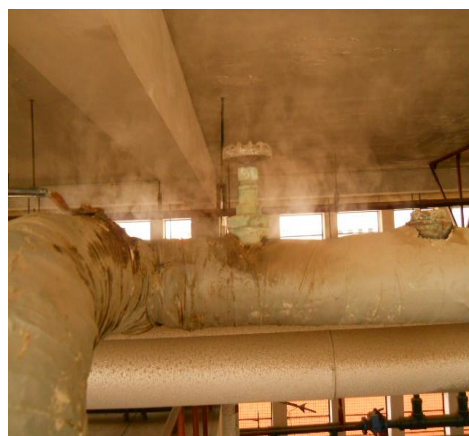
Fuga de vapor en válvula.
