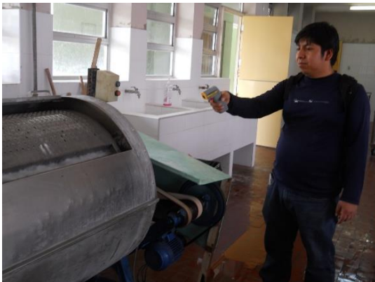
Medición de temperatura de mezcla agua y vapor en lavadoras.
