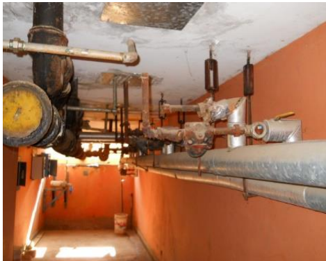
Ramal de retorno de condensado sin aislamiento.
