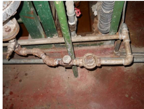
Ramal de esterilización sin aislamiento.
