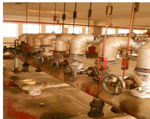
Filtrado de vapor en cabecero.
