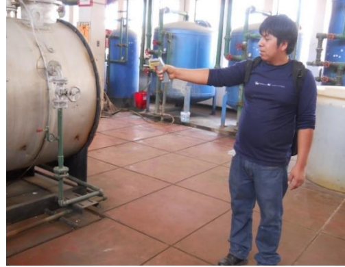
Medición de temperatura superficial en calderos.
