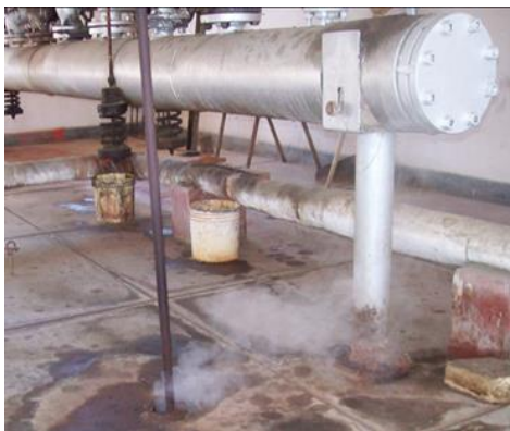
Fuga de vapor en cabecero.
