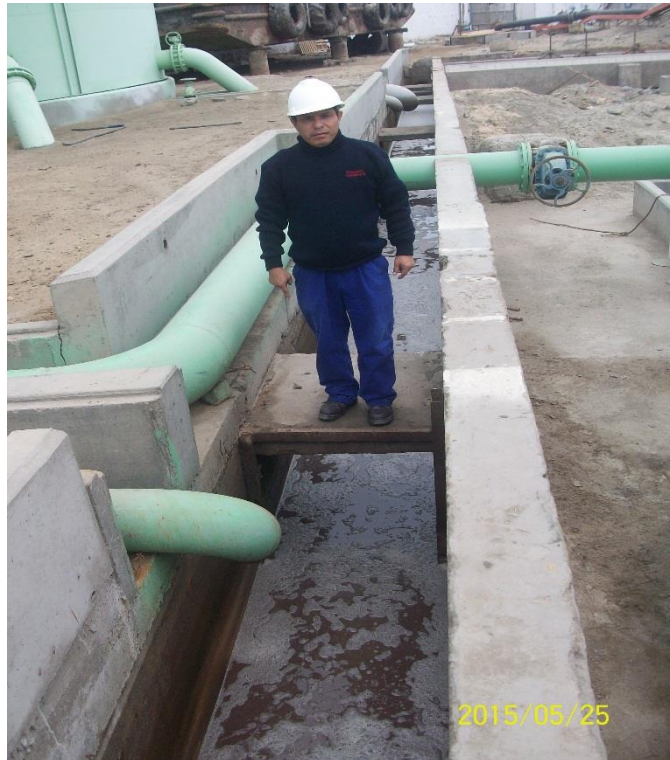
Flujo de agua de bombeo al emisor submarino
