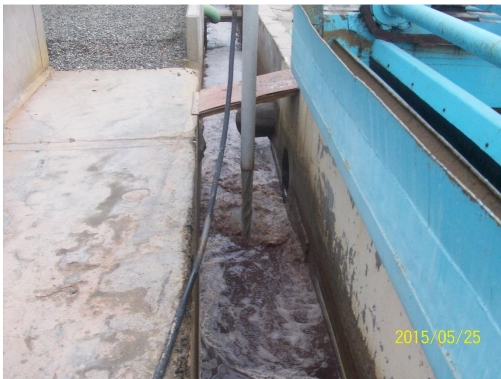
Aguas de limpieza de planta camino al emisor submarino
