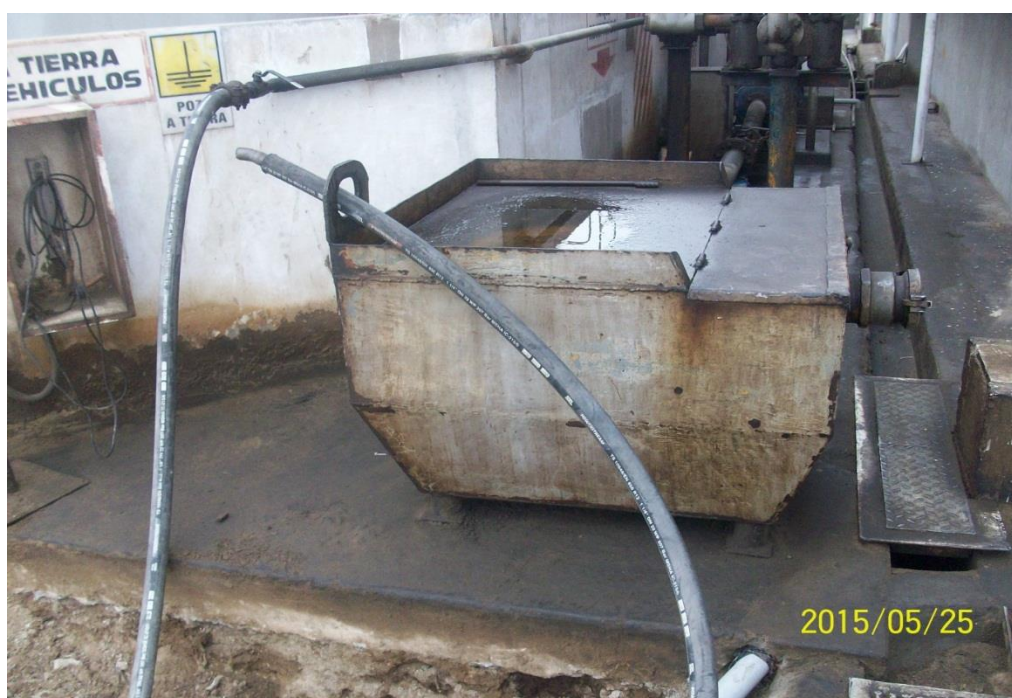
Contaminación del suelo por derrame de petróleo diésel 2.
