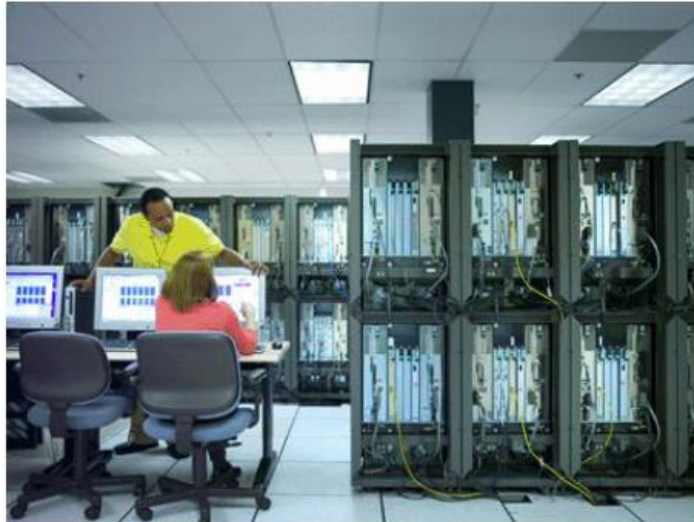
Ilustración 13: Cuarto de entrada de servicios
