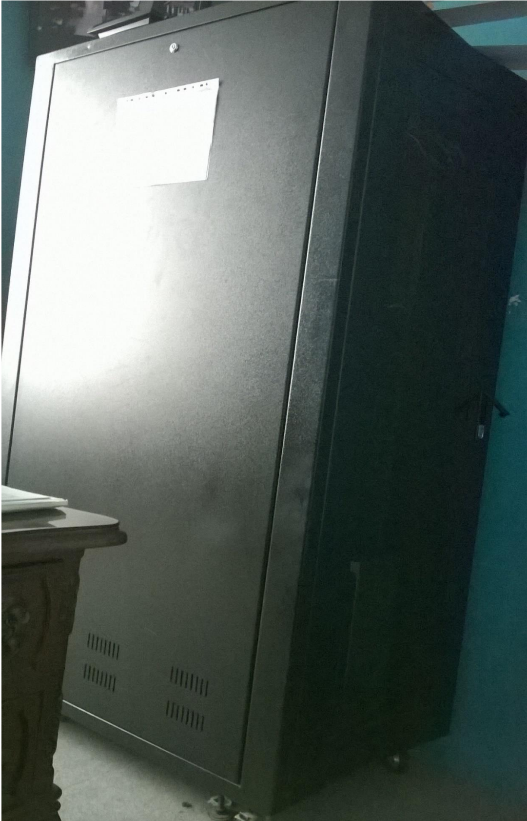
Ilustración 94: Servidor Corporación MW
