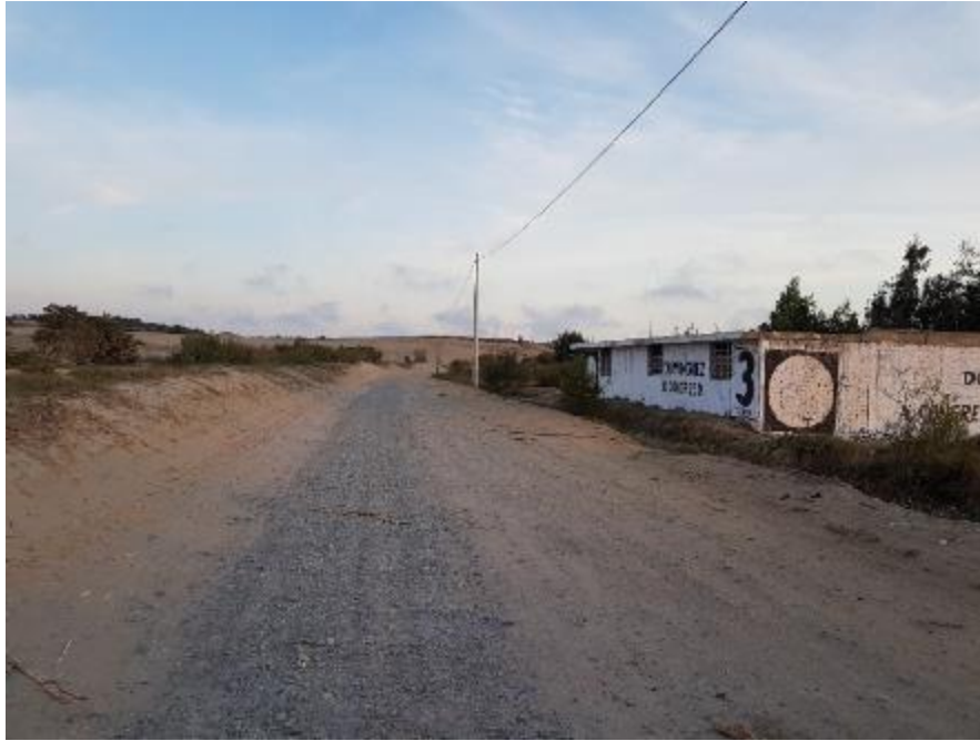
Figura 3: Presencia de desprendimiento de material
