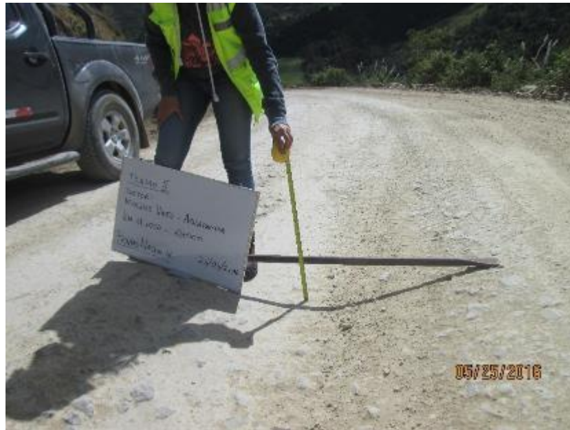
Figura 9: Huellas/hundimientos presentes en la calzada > 10 cm.
