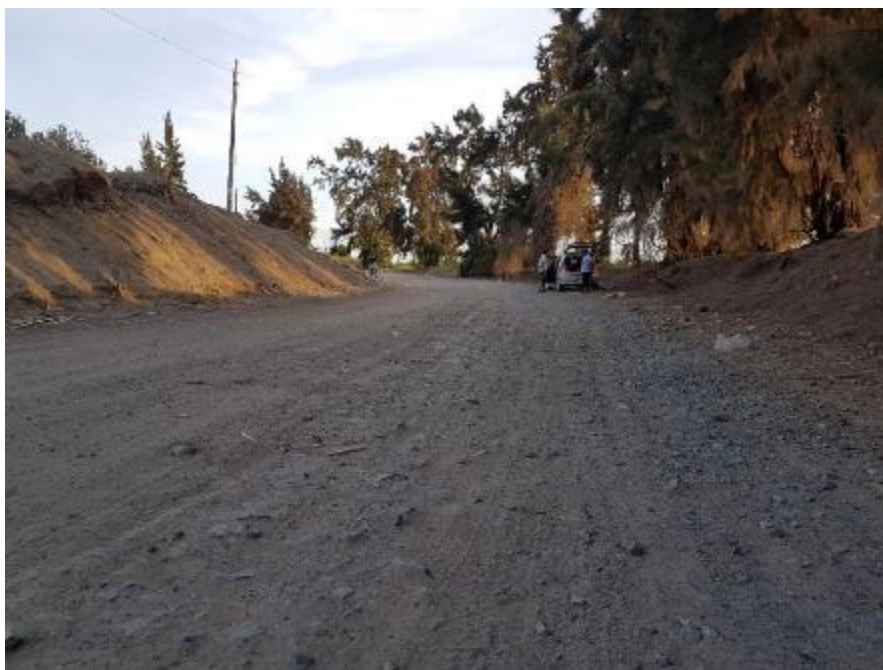
Figura 4: Presencia de calzada erosionada, baches y desprendimiento de material.
