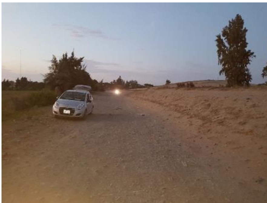
Figura 2: Presencia de calzada erosionada y desprendimiento de material.
