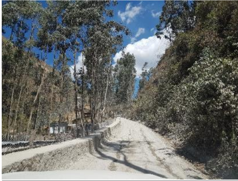
Figura 10: Presencia de calzada erosionada < 5 cm.
