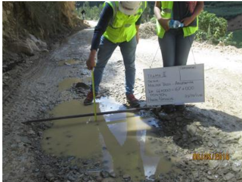
Figura 11: Presencia de bache en la calzada < 10 cm.
