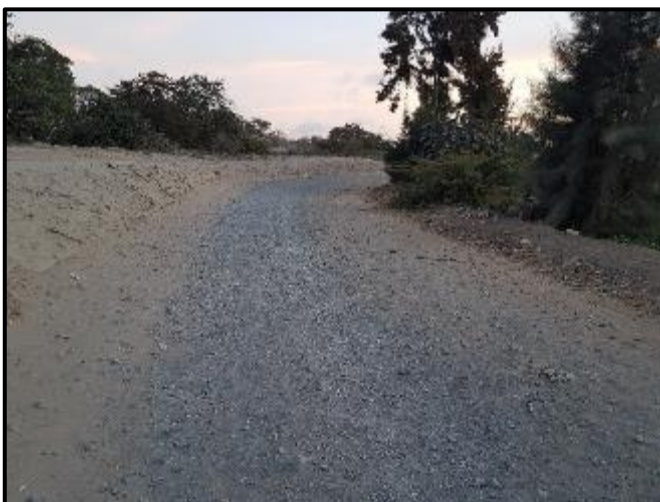
FOTO N°04: Parte de la carretera de Tangay presenta enripiado.
