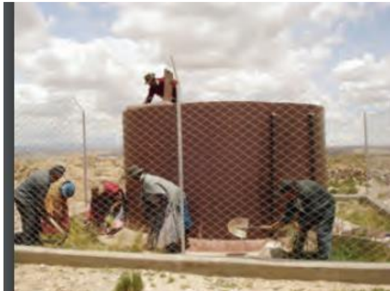
Figura N° 11 Mantenimiento anual de reservorio típico para bombas sumergibles en zonas alto andinas.
