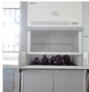
Cámara extractora de gases
