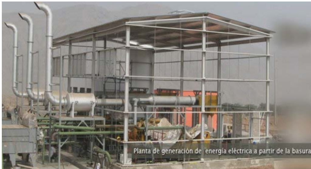
Figura N° 10 Central RSU de Huaycoloro de 2.4 MW
