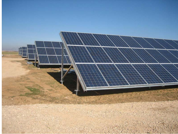
Figura N°7 Central Tacna Solar 20 MW
