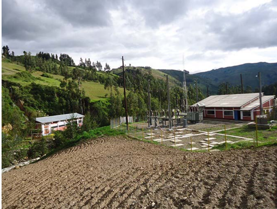
Figura N°13 Central Hidroeléctrica de Pariac de 18 MW
