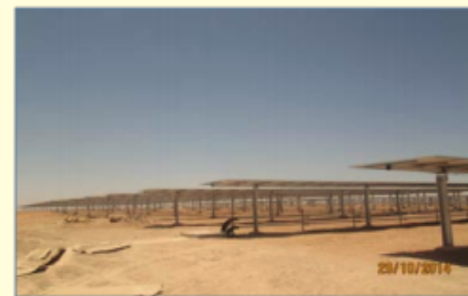
Módulos fotovoltaicos instalados
