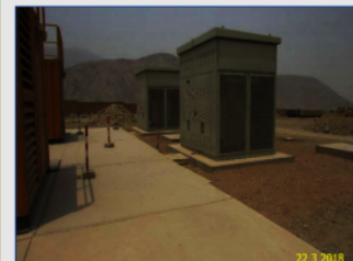
S.E. Transformación 1,5 MVA - 0,48/22,9 kV
