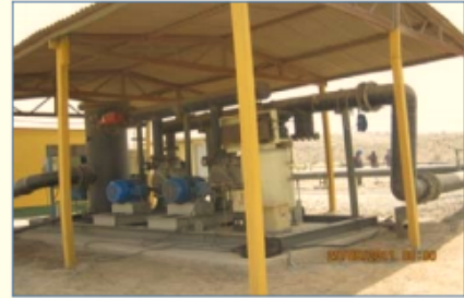
Planta de tratamiento de Biogás
