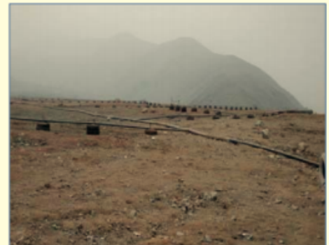
Pozos de extracción de gas
