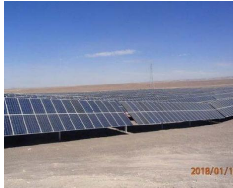
Figura N° 8 Central Fotovoltaica Rubí de 144 MW (Perú)
