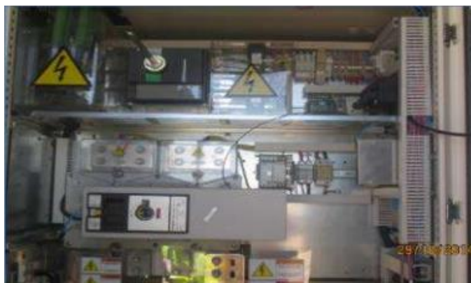
Figura 18 Conexionado del inversor de Central fotovoltaica de Moquegua. Fuente: Osinergmin (2020)
