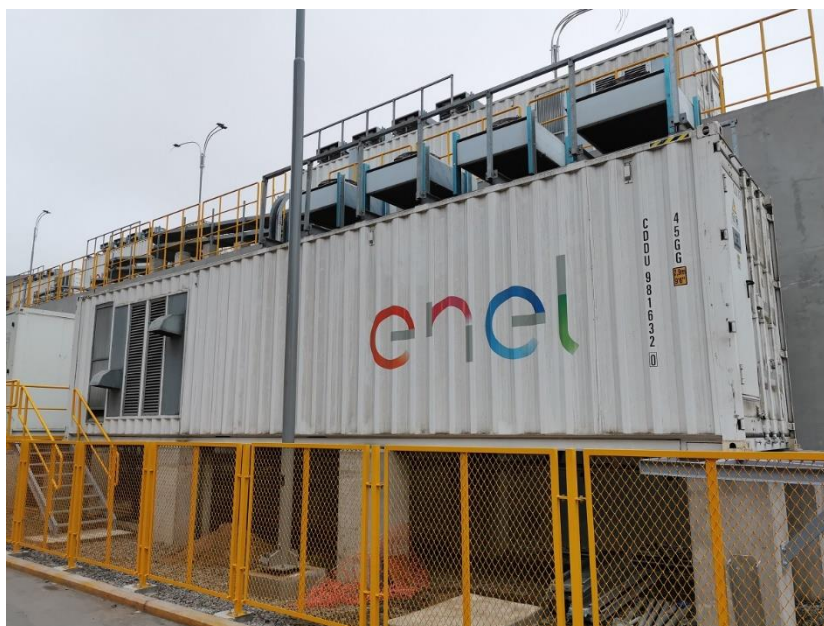
Figura 12 Sistema BESS con iones de litio de Central Térmica de Ventanilla para regulación de tensión y frecuencia
