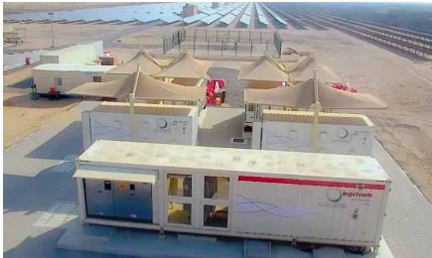
Figura 09 Batería de NaS en Dubai's Electricity & Water Authority (DEWA)
