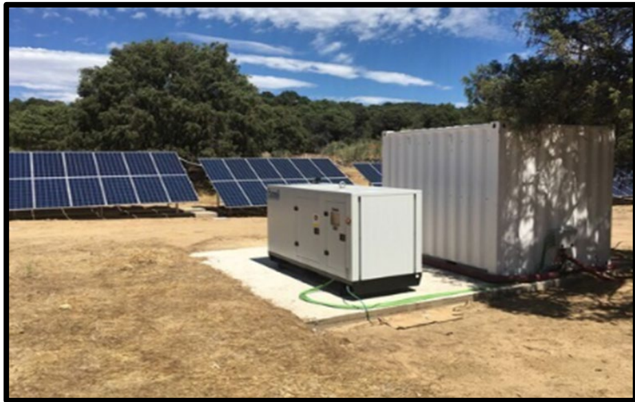
Figura 18: Sistema Fotovoltaico con Grupo Electrónico
