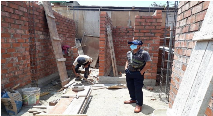
FOTO N°09 se observa los trabajos de habilitación de tablas de madera para empear con el encofrado de columnas
