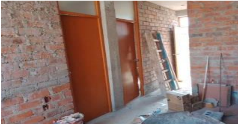
FOTO N°46 se observa el acabado en puerta contrapalacada en el interior dela vivienda
