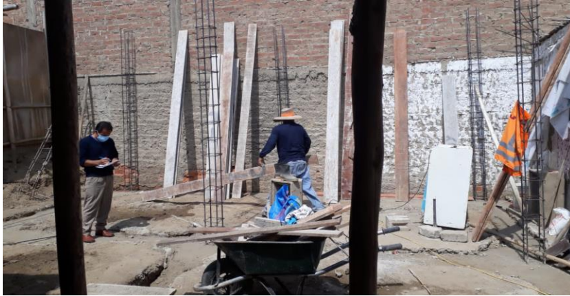
FOTO N°04 se observa ya las columnas plantadas y el cemento corrido ya colocado listo para colocar el encofrado de sobrecimiento
