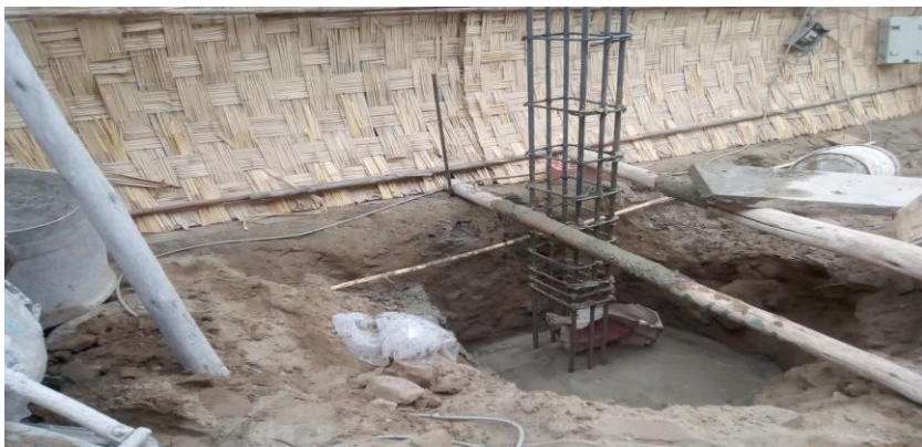
FOTO N°03 se observa los trabajos de colocación de columna y vaciado de concreto en zapata de columna
