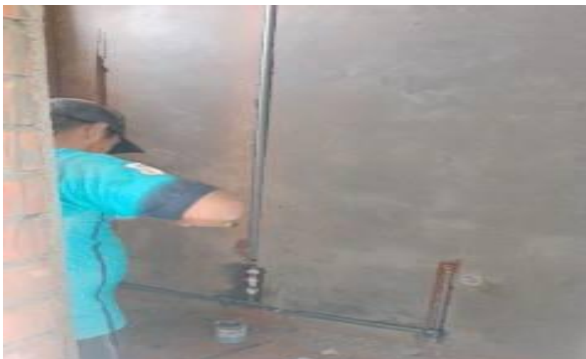
FOTO N°38 se observa la colocación de tubería para el agua en el baño
