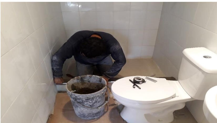
FOTO N°41 se observa los trabajos de colocación de los acabados con cerámico en la ducha y colocación de inodoro del baño
