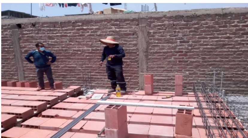
FOTO N°21 se observa la colocación de ladrillo de techo y acero en viguetas de la loza aligerada
