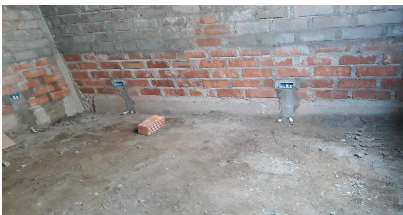
FOTO N°32 se observa la instalación eléctrica en cajas de tomacorriente
