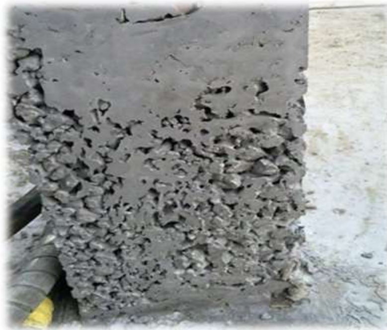
Figura 8. Segregación del concreto.
