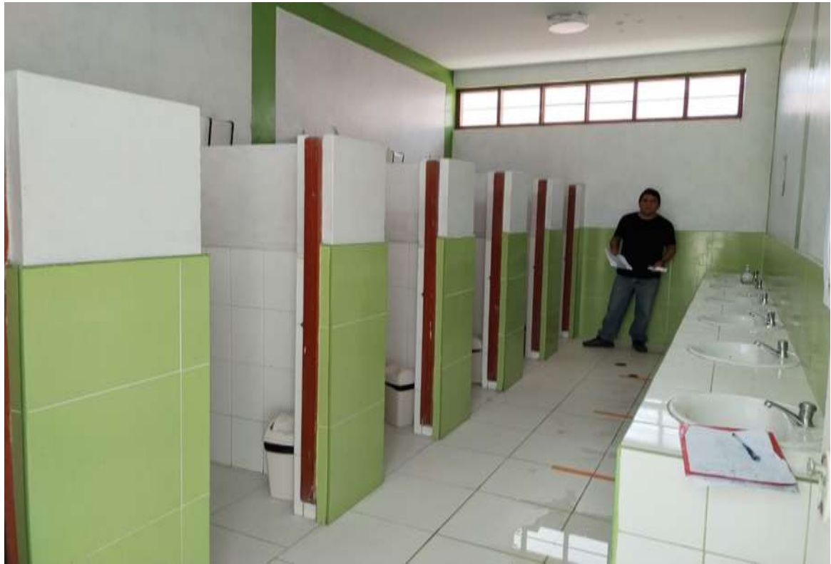
FOTO N° 09: S.S.H.H. DE VARONES EN BUEN ESTADO, FUNCIONANDO
