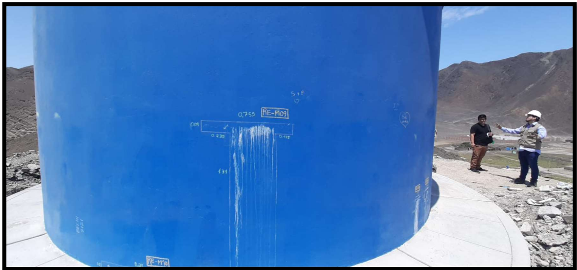
Foto 08: Inspección visual del reservorio
