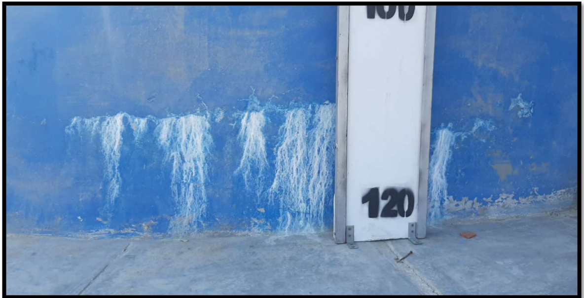
Foto 10: Identificación de patologías
