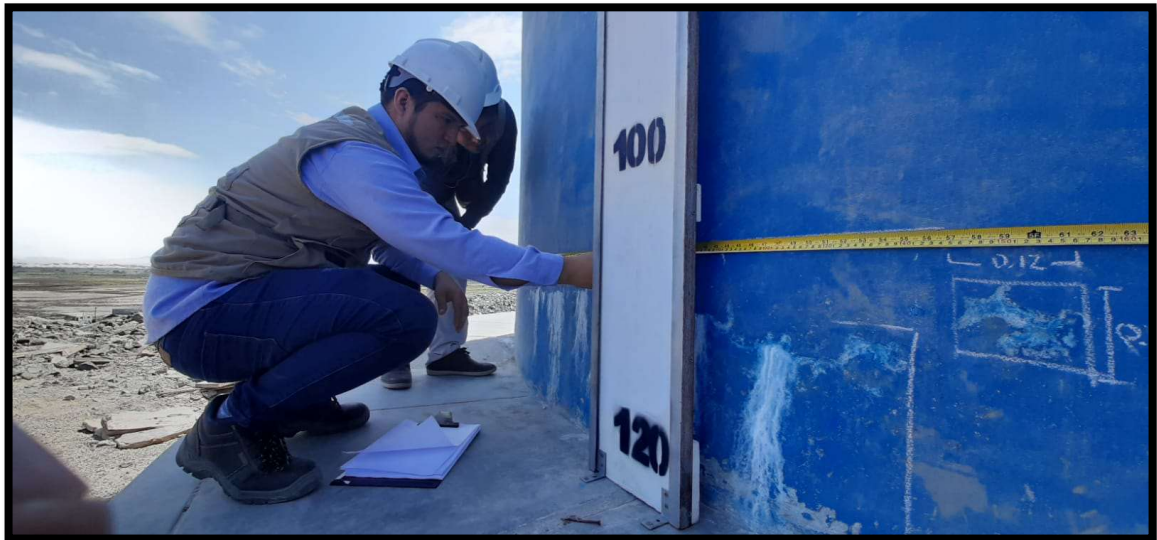
Foto 12: Medición de las patologías
