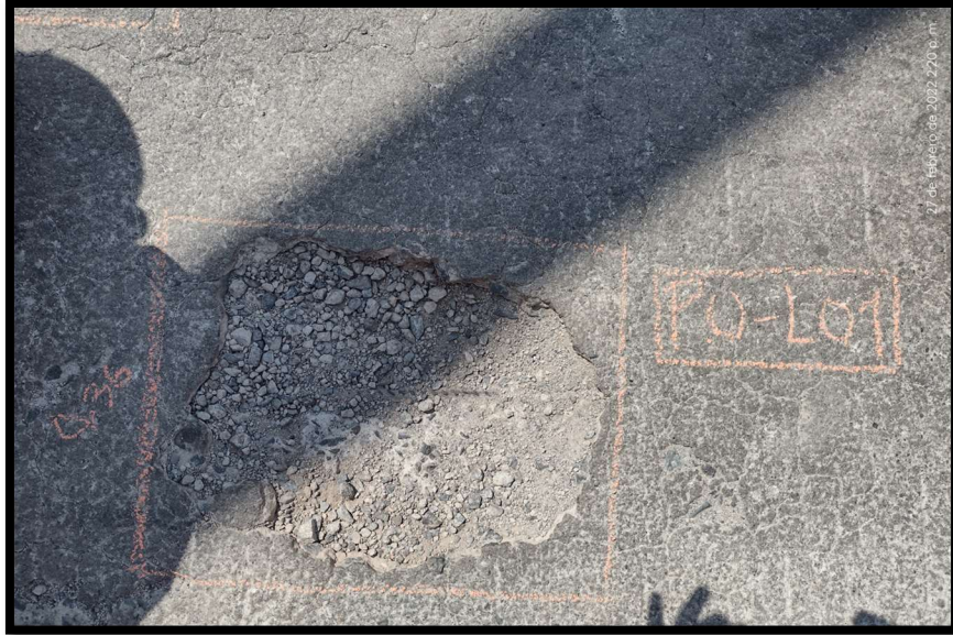
Foto 03: Identificación de las patologías - puente
