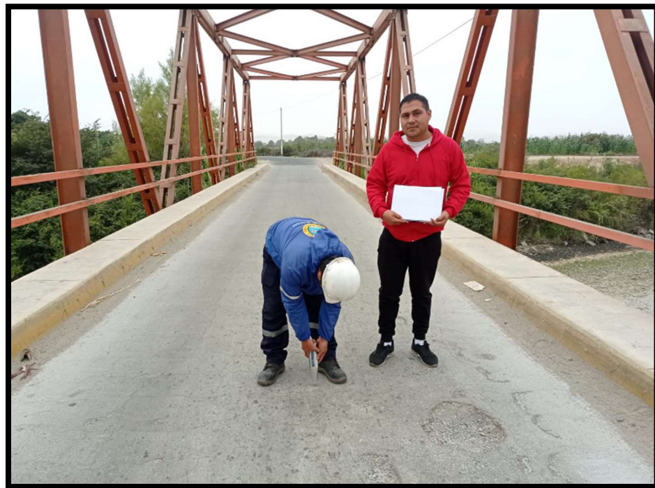
Foto 06: Ensayo no destructivo de esclerometría para estimar la resistencia del concreto en la unidad muestral más crítica en el puente
