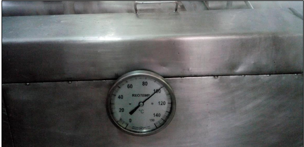
Figura 27: Medición de la temperatura del Exhauster.
