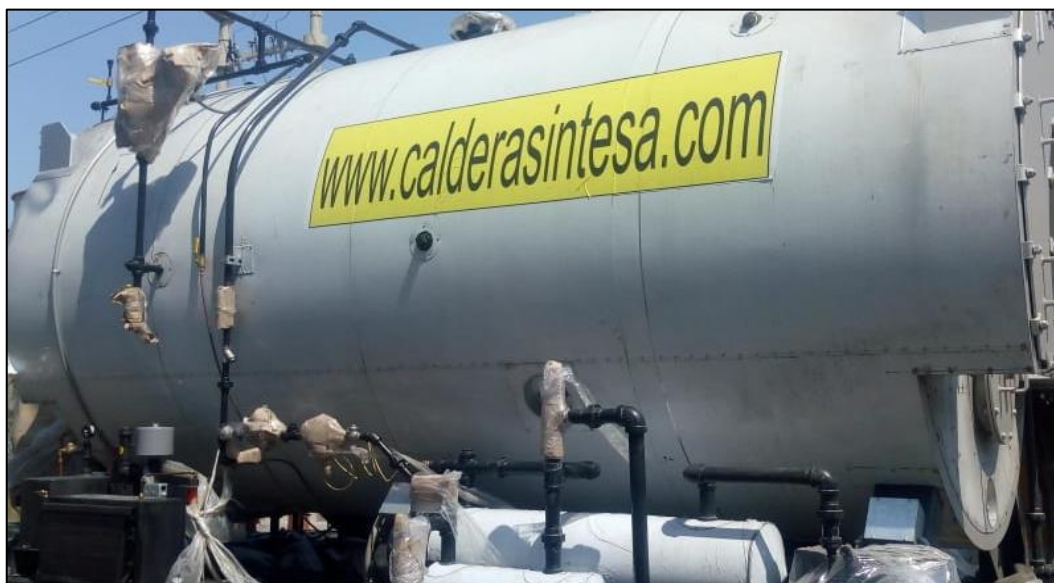
Figura 13: Caldero para generación de vapor.
