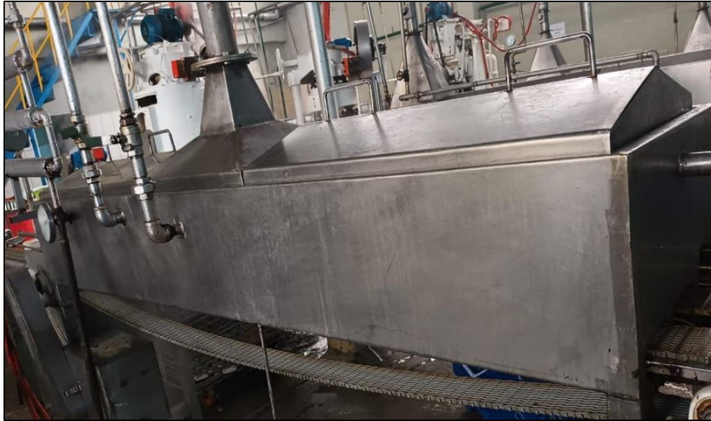
Figura 7: Exhauster para eliminar el aire frío del envase.
