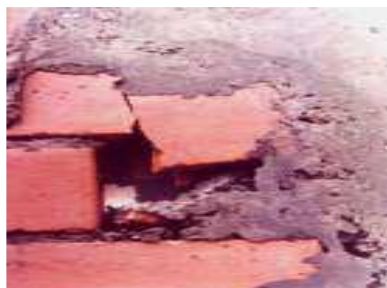
Figura 42 Diente fracturado y formación de cangrejas en unión columna-muro.
