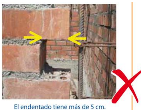
Figura 41 Incorrecta dimensión del dentado muro-columna.
