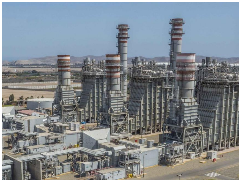
Central Termoelectrica de Kallpa de 870 MW
