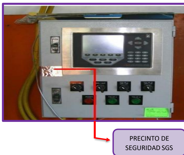
Fig.22. Tablero de control eléctrico
